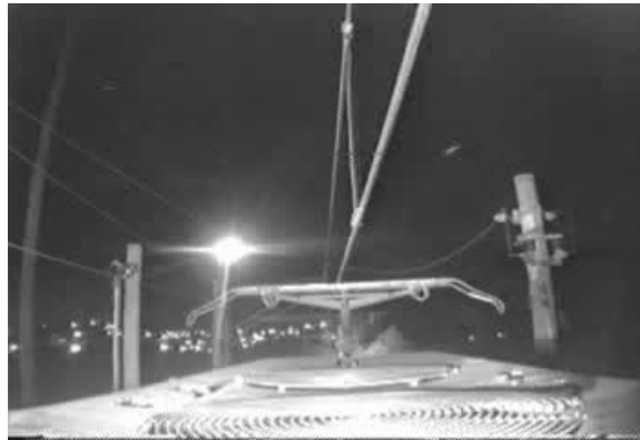
TUE OPERANDO COM DOIS PANTÓGRAFOS ELEVADOS - REGULAGEM DE 4 kgf.
